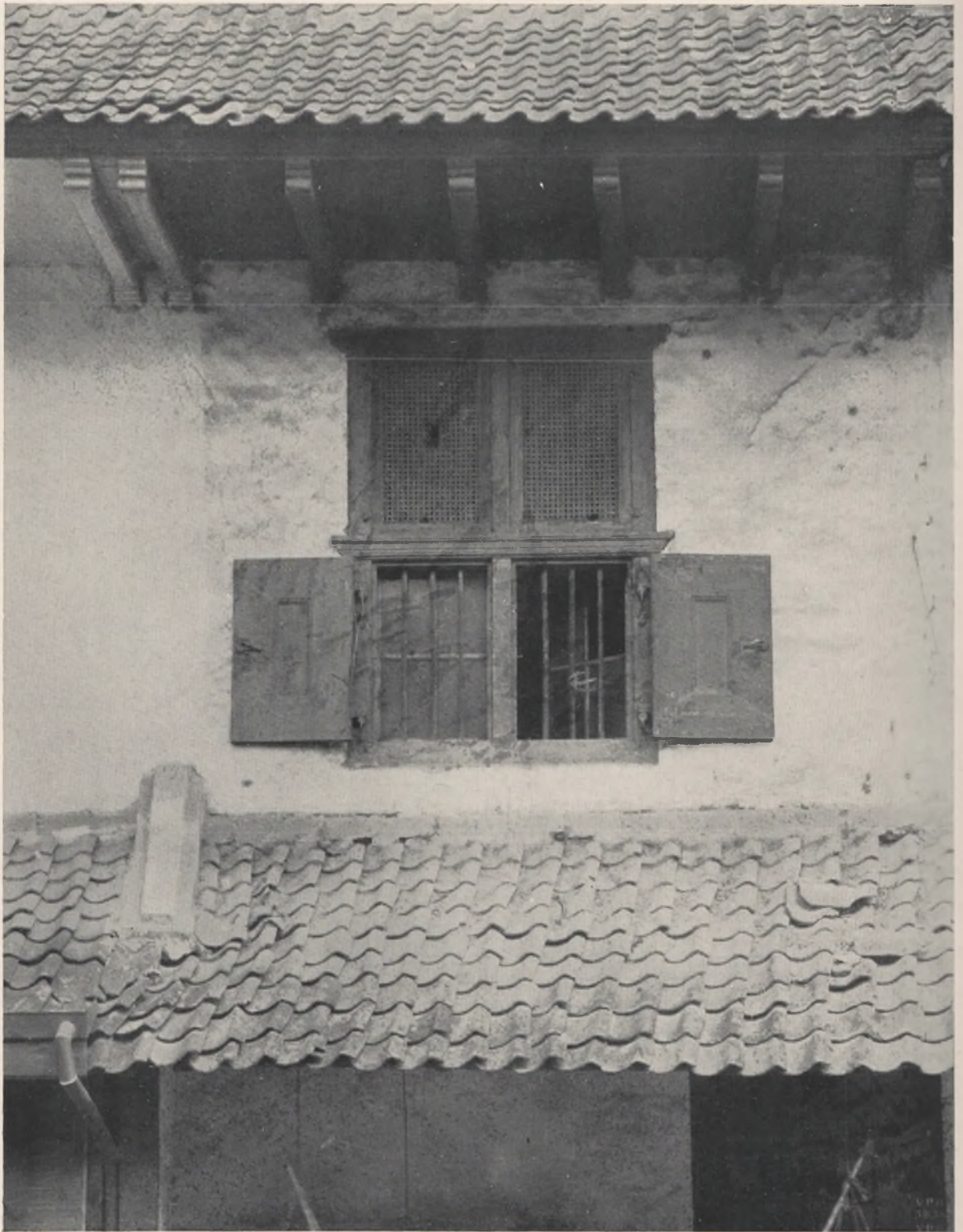
B 32. Rotanvenster aan de bovenverdieping (straatzijde) van een huis in de Utrechtsche straat met een deel van den uitstecker. Vergelijk § 1084. Men merke op het fraaie lijstwerk. De beide rotanraampjes kunnen open.
