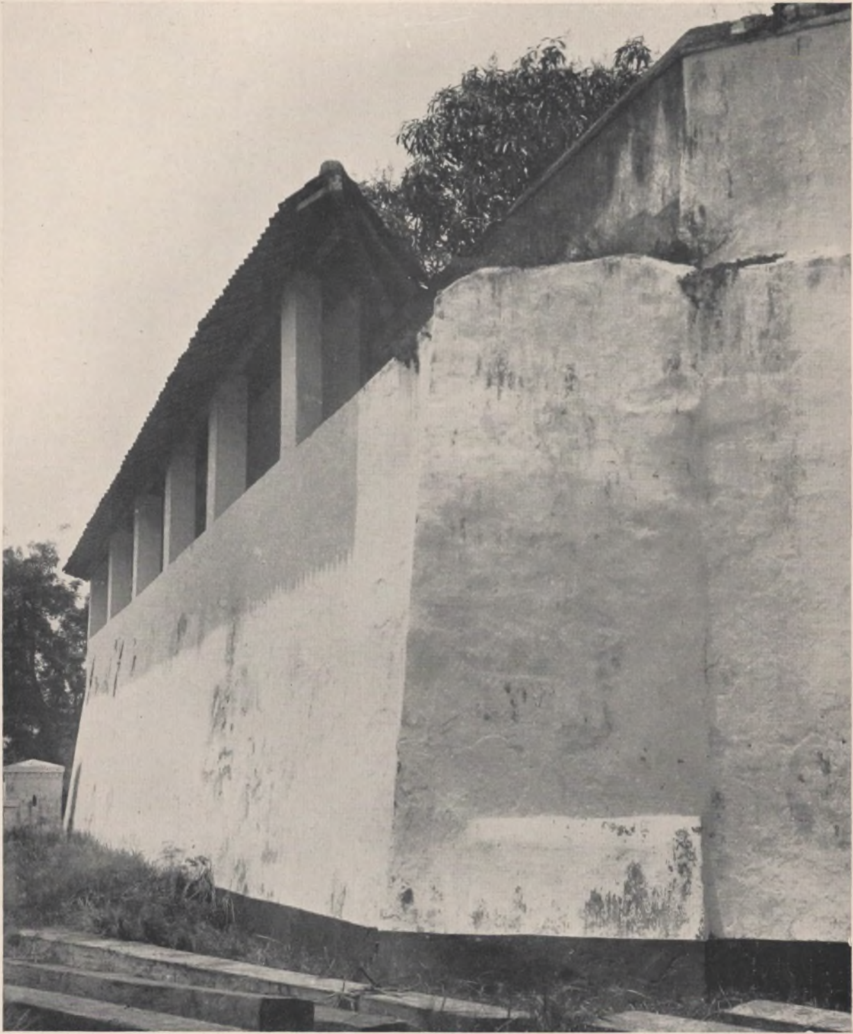
A 26. Gezicht uit het Westen op het westerdeel der Graanpakhuisen (§ 694). Men staat hier (zie de kaart van Van der Parra) met den rug naar den Robijn en ziet voor zich aan de rechterzijde het punt waar de verbindingsmuur van 30 Meter lengte begon, die uit den hoek der Graanpakhuisen liep naar het saillant van den Robijn (§ 378). Het schilderhuisje staat op het hoekpunt van den stompen hoek, welks eene been de lange wal vormt, die op onze photo A 27 gedeeltelijk te zien is en naar de punt Amsterdam liep. De hoogte van den muur is, de borstwering meegerekend, ongeveer 6.75 Meter.
