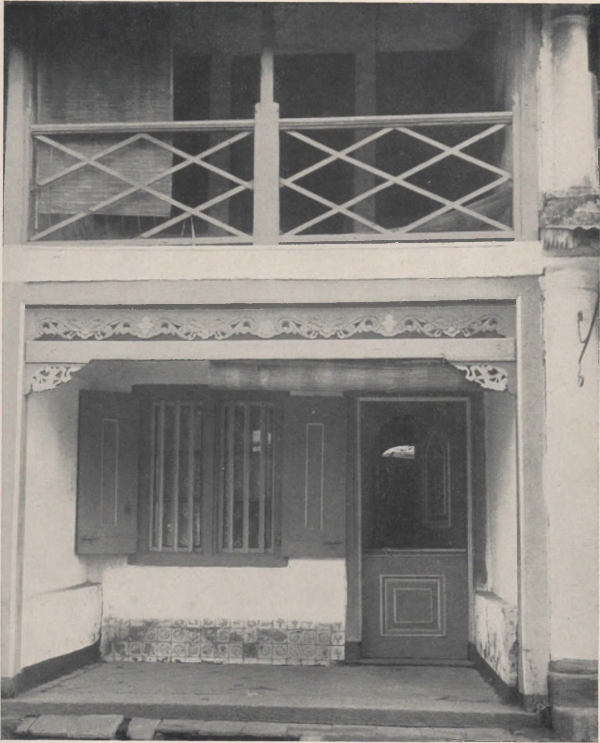
B 20. Gevel van een Moorsch huisje aan Bacherachtsgracht Noord met eene plint van vier rijen Hollandsche tegeltjes (§ III 6). Aangezien men deze plint wel niet zal hebben begonnen met eene rij kapotte tegels, zal men moeten aannemen dat de vloer een gedeelte der onderste rij bedekt en er later aan is toegevoegd. Waaruit volgt dat de hierop steunende balken der bovengalerij en deze galerij zelf ook niet tot den bouw behoorden. Men vergelijkte de paneelen der straatdeur met de elders vermelde (B 27; 28; 29; 30).
