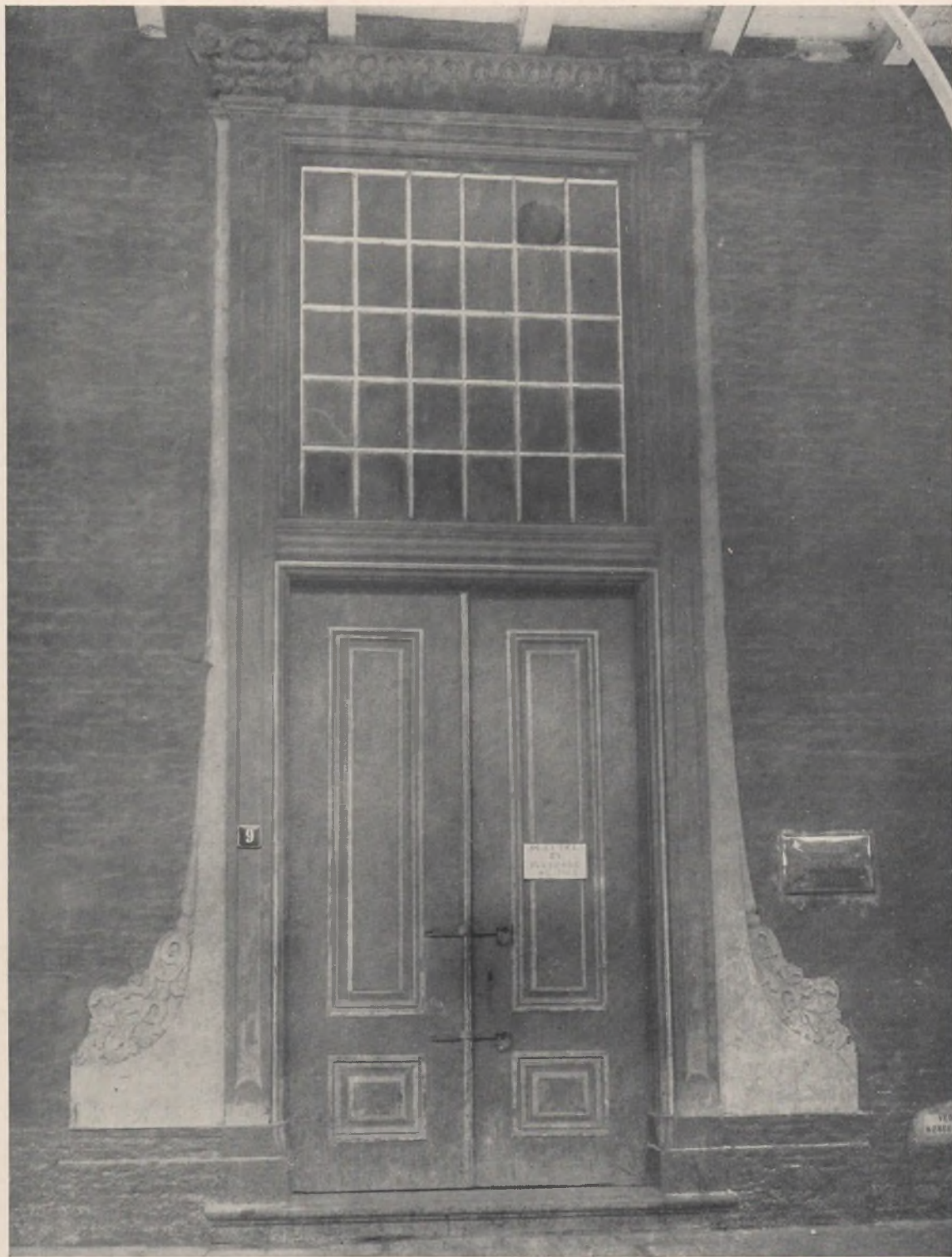
B 26. Straatdeur van een der beide huizen Toko Merah vóór de restauratie als Bank voor Indië. Men ziet hier nog den vloer der houten kast, die vroeger de bovenverdieping aan het gezicht onttrok. De muur is donkerrood geverfd en het fraaie metselwerk is onzichtbaar. Men merke het hooge bovenlicht op, hetwelk een ouderen stijl verraadt dan dat der moskee A 28 en loch nog, naar verhouding, minder hoog is dan het bovenlicht der straatdeur van het huis hierbezuiden, waaraan onze photo B 23 is ontleend.
